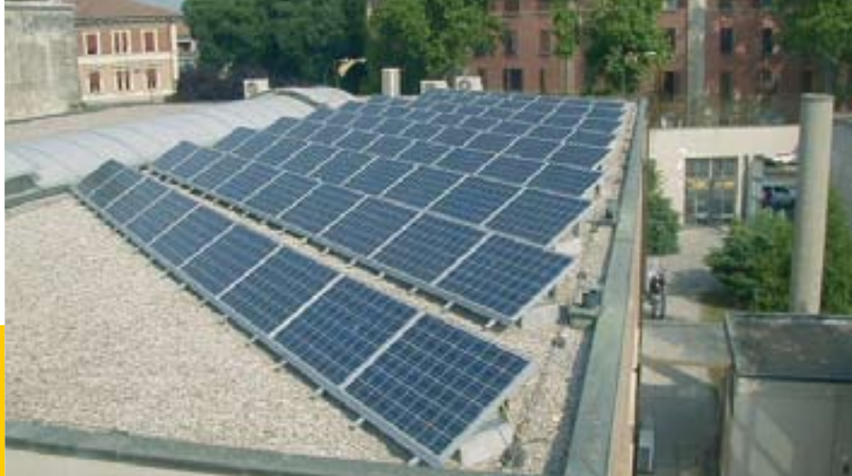
Esempio di pannelli fotovoltaici su tetto a terrazza
